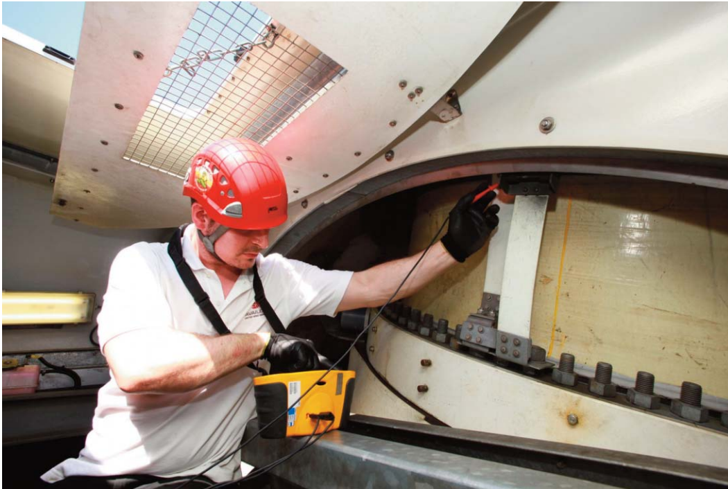
Bild 2: Die Entwicklung eines Verfahrens für eine BGV A3-Prüfung mit all ihren Feinheiten, zu denen unter anderem die Festlegung eines Prüfablaufs inklusive aller Messpunkte, die Wahl der für die Prüfung geeigneten Messgeräte bis hin zur Dokumentation der Prüfergebnisse und der Erstellung eines Prüfprotokolls gehört, ist aufwendig.
